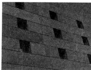
人造石材外墙
